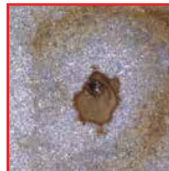
Ejemplo de corrosión de picadura
