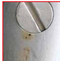
Ejemplo de corrosión de picadura
